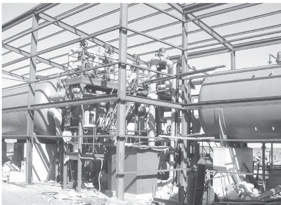
Una de las desaladoras instaladas en Canarias.
